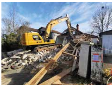
| Destruction de la maison attenante au chantier - février 2021
